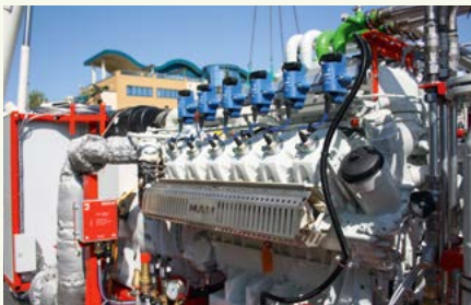
BHKW-Modul vor Einbau in die Maschinenhalle
